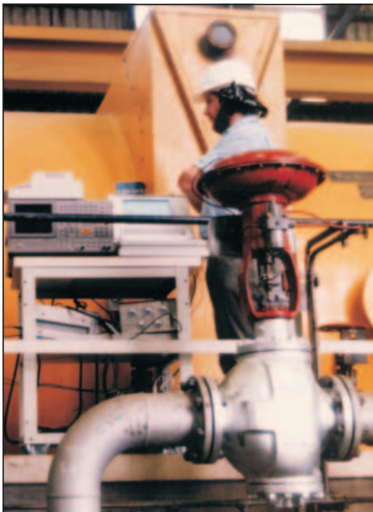
Caractérisation et contrôle de l'environnement dans une grande installation industrielle.
